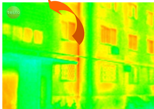
Потери через стыки стен по фасаду здания
